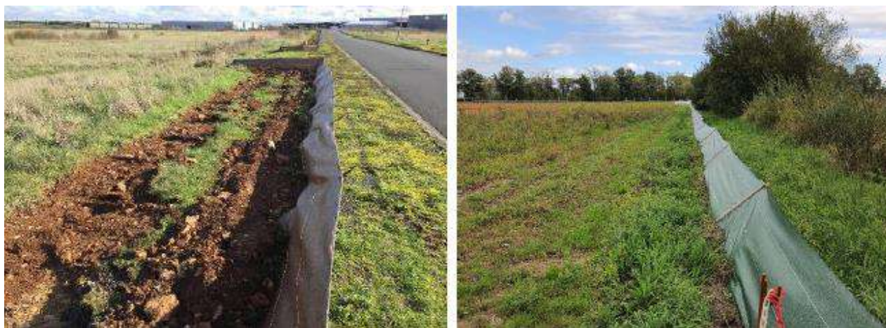
Figure 156 : Exemples de filets de protection à sens unique de la petite faune terrestre mis en place au niveau de divers chantiers
